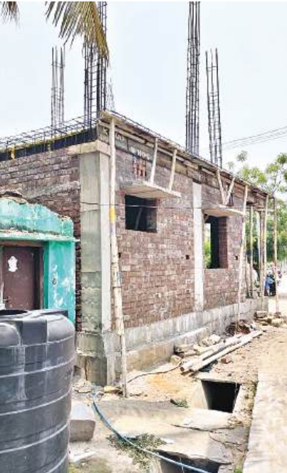
అనంతనగరంలోని నవోదయ కాలనీ స్మశాన వాటిక కాంపౌండ్ వాల్ కు అనుకొని రోడ్డును డ్రైనేజీ కాలువను ఆక్రమించి ఇలా నిర్మాణం సాగుతున్న దృశ్యం
